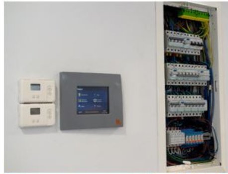
Figura 2: Panel de control de gestión para cada estancia del edificio.
